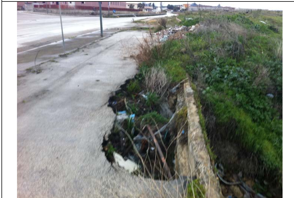
Foto n. 40 – Frana Piazza del Lavoro
