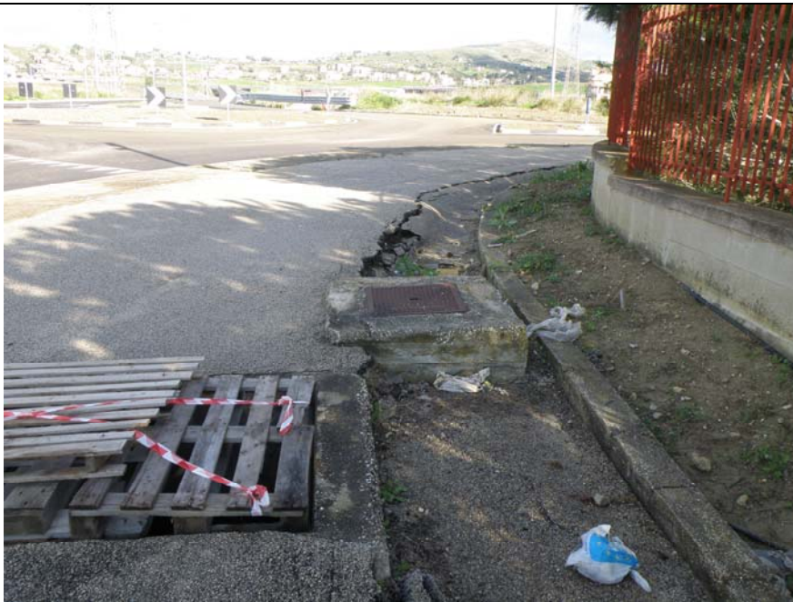
Foto n. 37 – Manto stradale degradato
