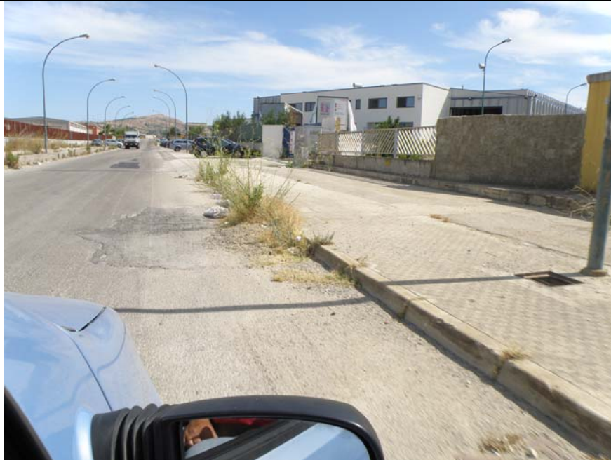
Foto n. 32 – Manto stradale degradato
