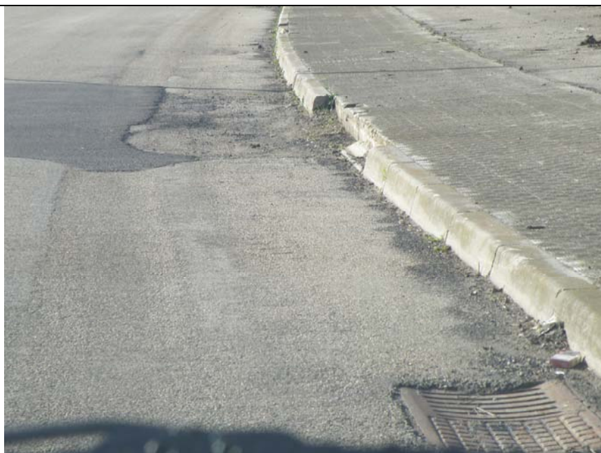
Foto n. 33– Manto stradale degradato
