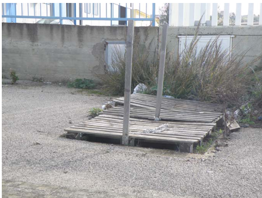
Foto n. 26 – Pozzetto da sistemare
