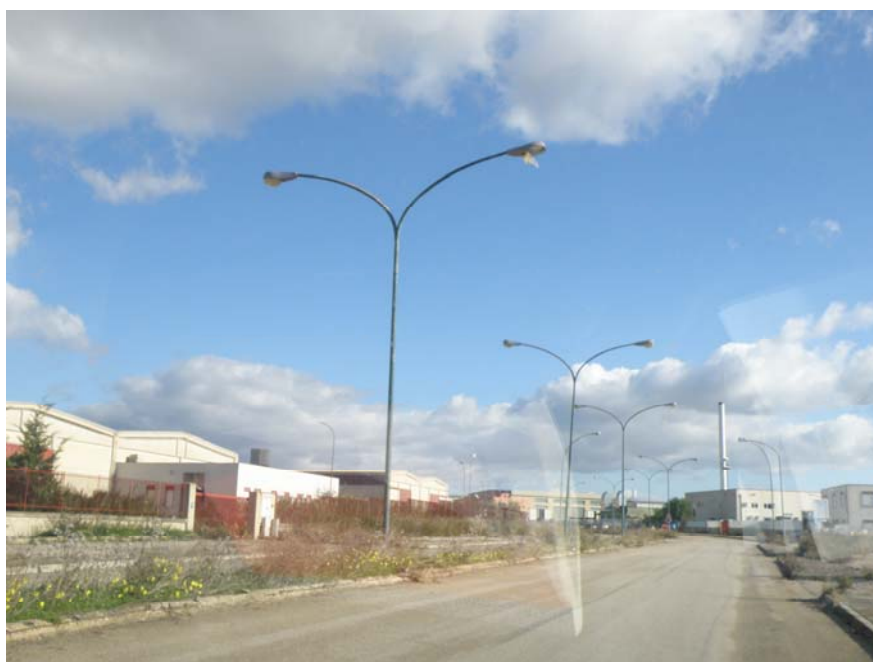
Foto n. 24 – Palo di illuminazione
