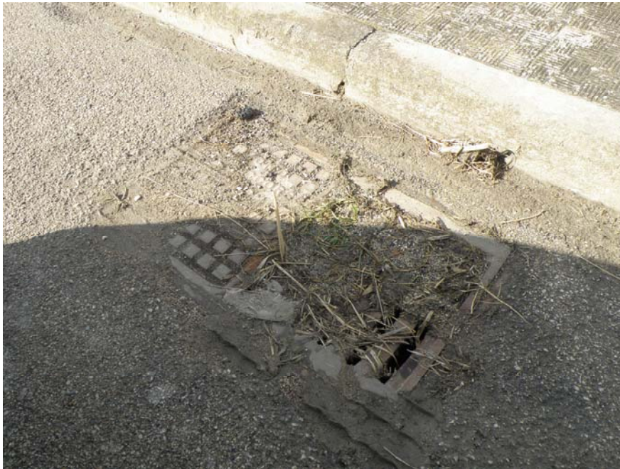
Foto n.15 – Caditoie da manutenzionare
