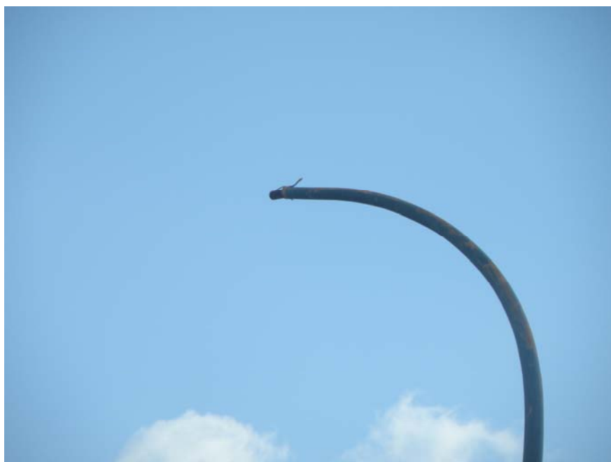
Foto n. 25 – Palo di illuminazione da sistemare
