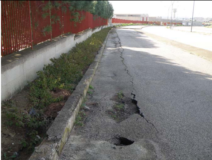
Foto n. 38 – Manto stradale degradato
