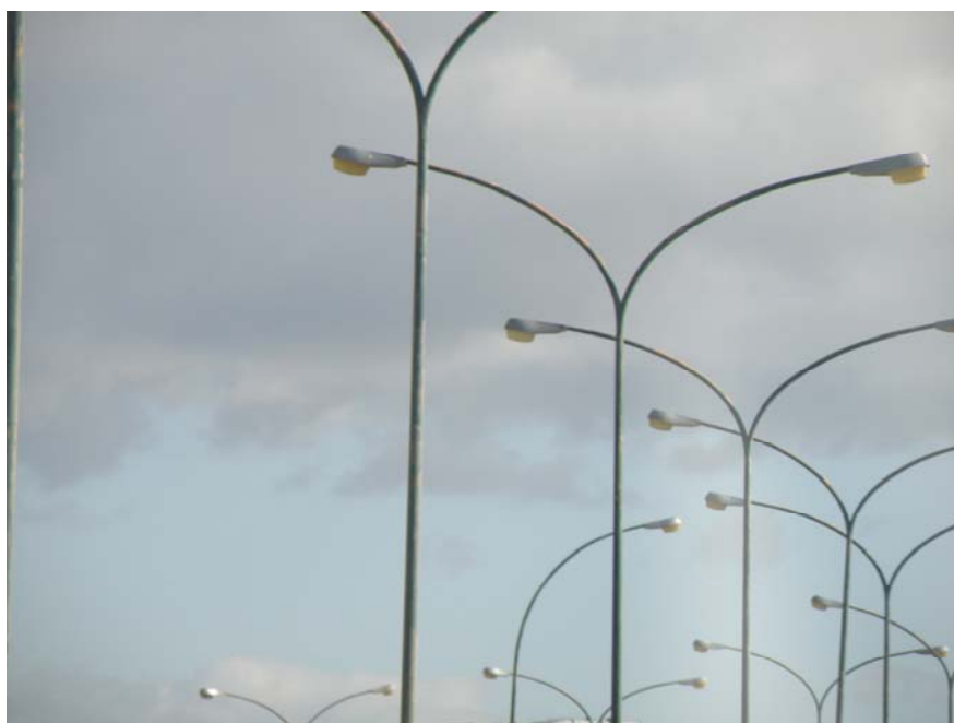
Foto n. 20 - Pali di illuminazione
