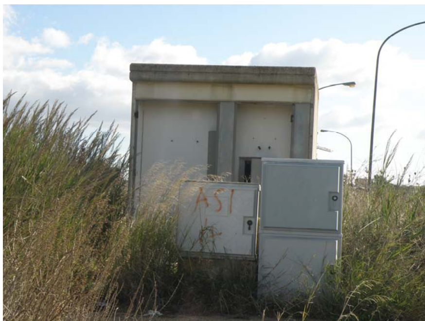
Foto n. 19 – Cabina e quadro elettrico
