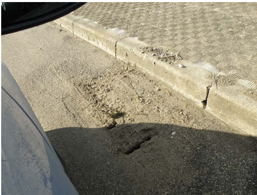
Foto n.14 – Caditoie da manutenzionare
