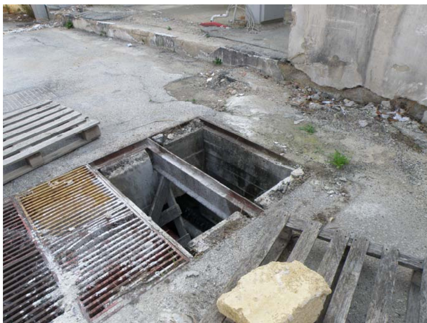
Foto n. 27 – Pozzetto da sistemare
