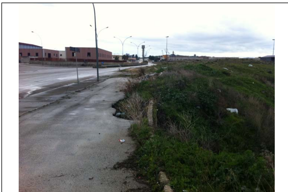
Foto n. 39 – Frana Piazza del Lavoro
