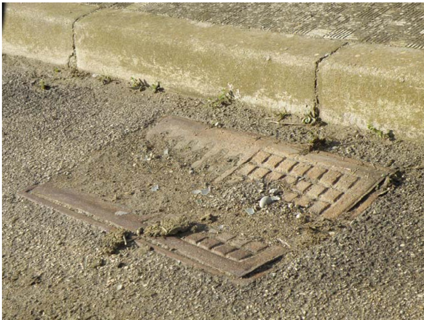
Foto n.13 – Caditoie da manutenzionare
