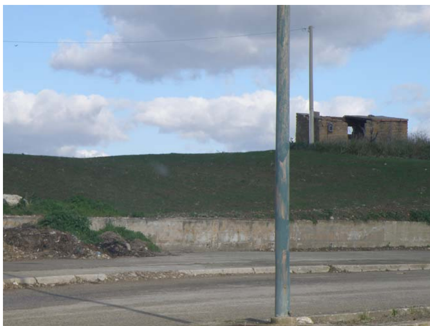
Foto n. 28 – Pali di illuminazione da verniciare
