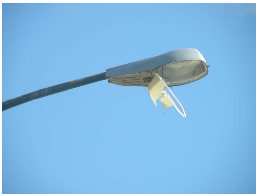
Foto n. 23 – Palo di illuminazione da sistemare
